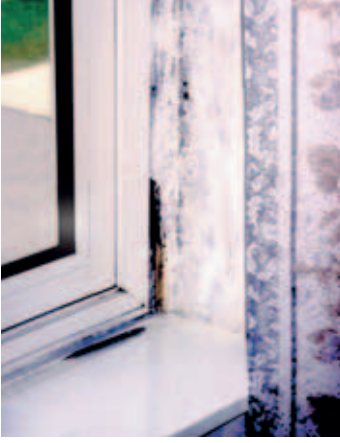
Pencere boşluklarında küf mantarı istilas
